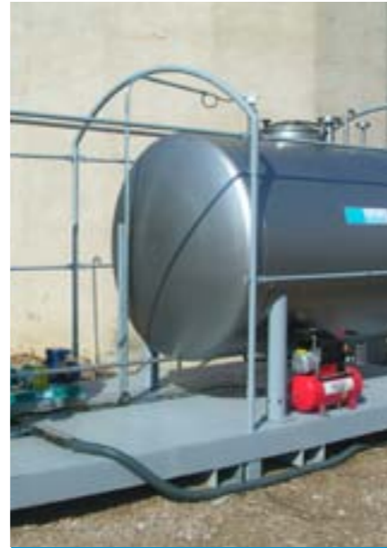
Esta primera planta capacitada para tratar agua contaminada proveniente de los acuíferos del municipio de El Morell (Tarragona) es el primer ejemplo de aplicación de la tecnología desarrollada en Catalunya.
